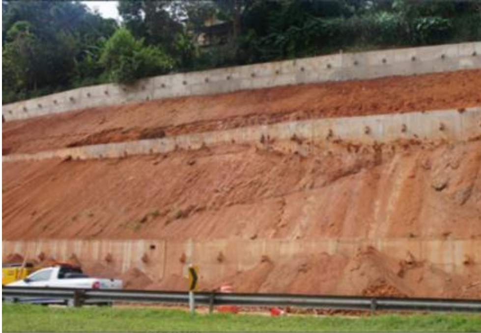
Figura 23: Contenção de taludes em margem de rodovia por cortinas ancoradas.
