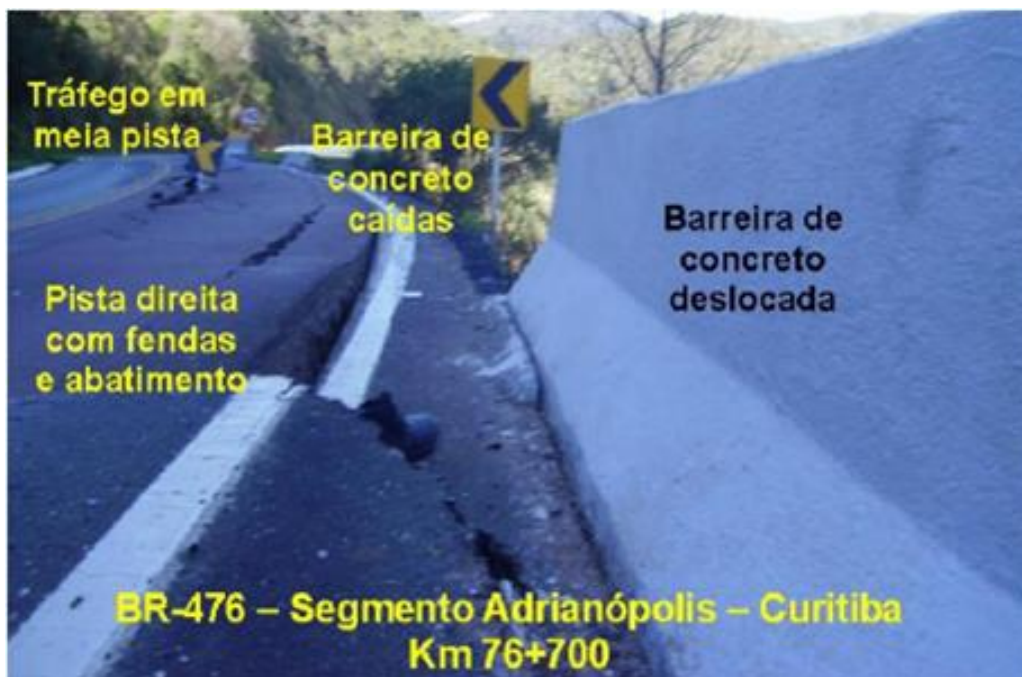
Figura 21: Rompimento de pista e barreira de concreto.
